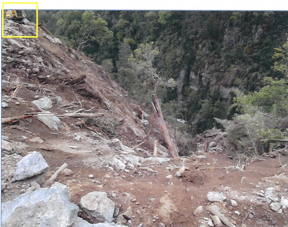
Fotografía N°10. Caída de material, rocas y árboles a estero Nacimiento y maquinaria en operación.
