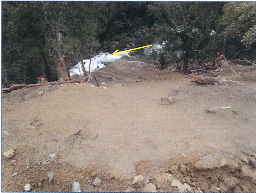
Fotografía N°9. Caída de material y árboles a estero Nacimiento.
