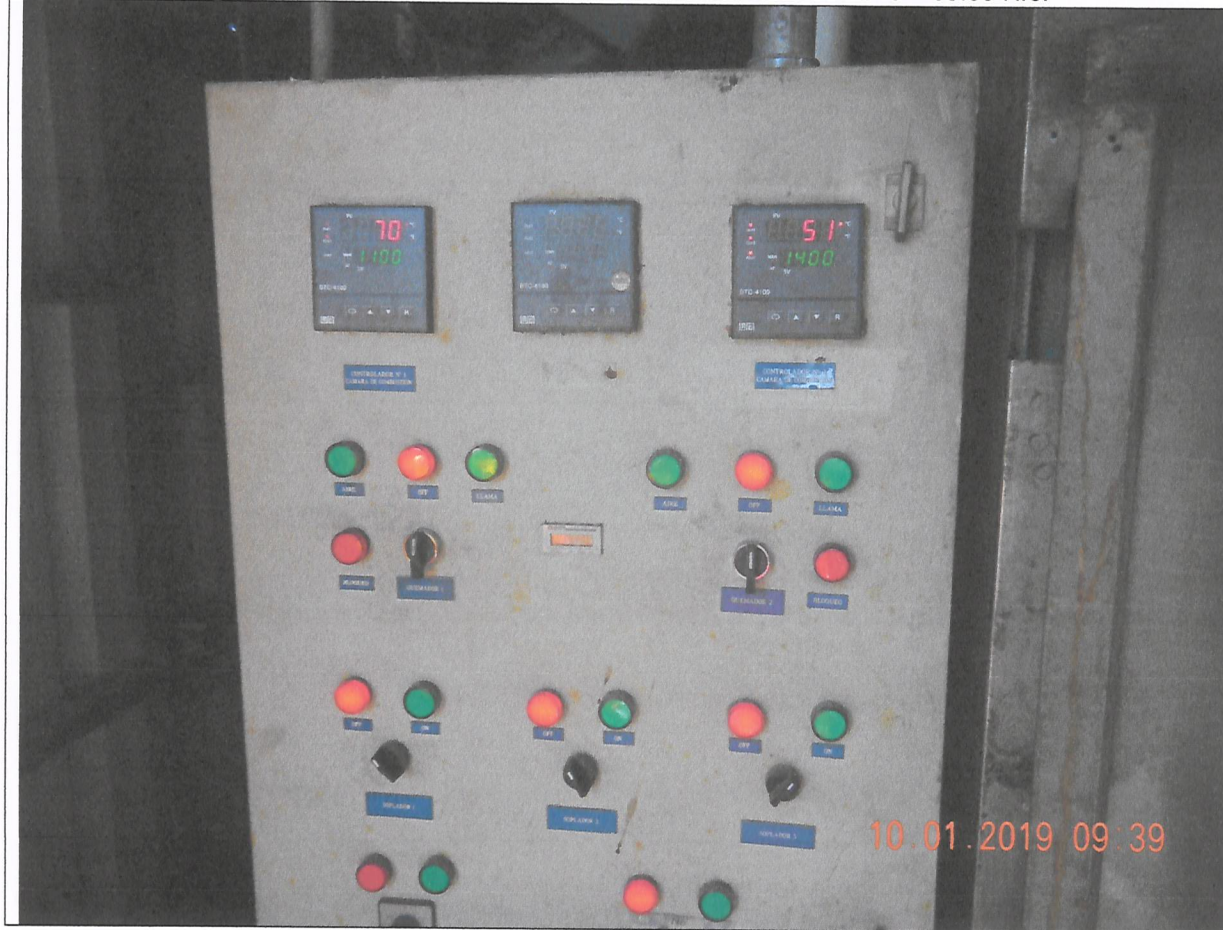
Imagen N°5: Registro Mantenimiento Incinerador - Jueves 10 de enero de 2019 – 09:39 Hrs.
