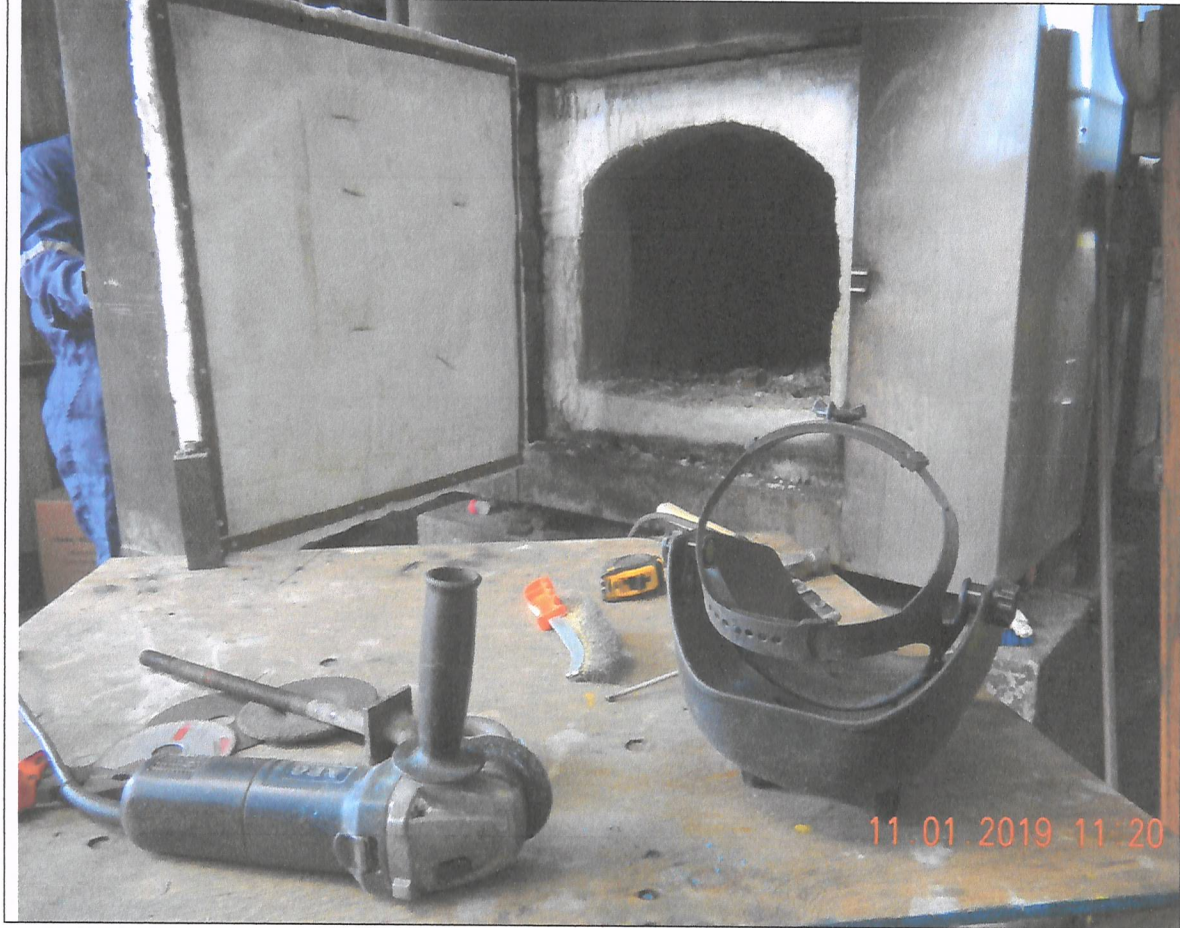
Imagen N°12: Registro Mantención Incinerador - Viernes 11 de enero de 2019 – 11:20 Hrs
