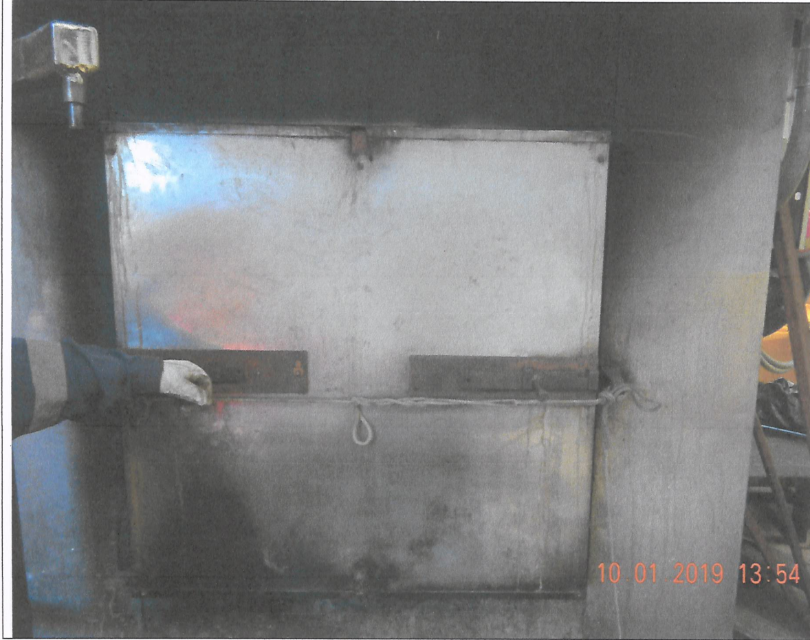
Imagen N°9: Registro Mantenimiento Incinerador - Jueves 10 de enero de 2019 – 13:54 Hrs
