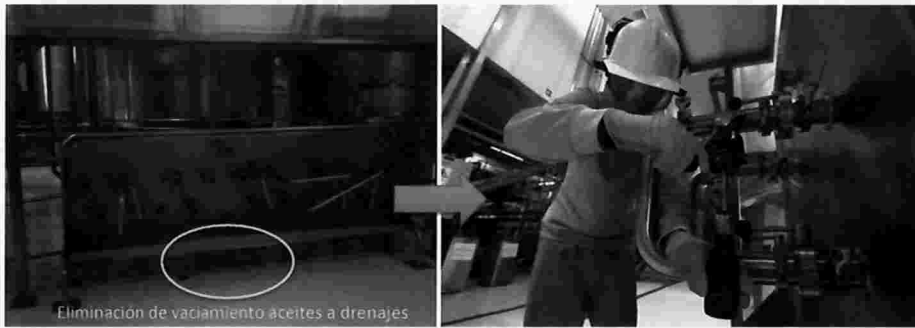
Eliminación de vaciamiento aceites a drenajes
