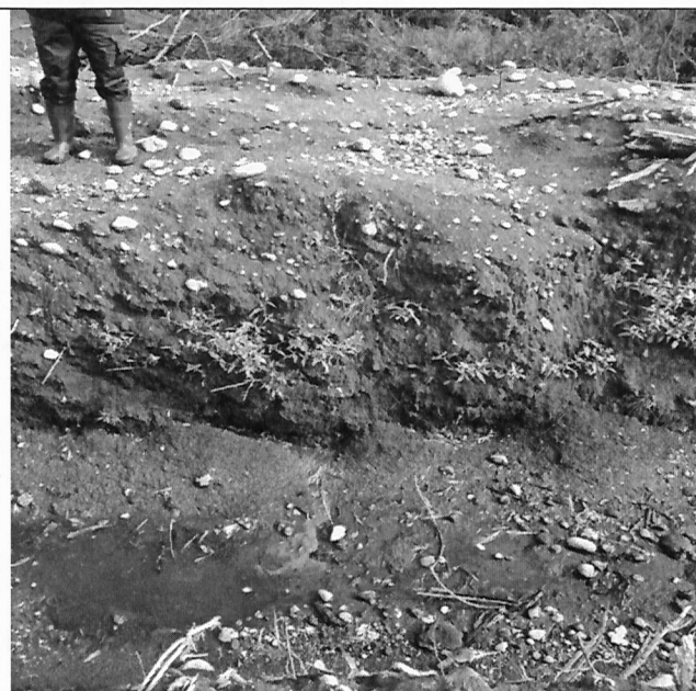
Fotografía N°7: Afloramiento de líquidos lixiviados en canal de aguas lluvias en pared lado oeste del vertedero
