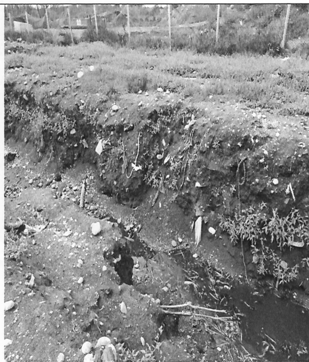
Fotografía N° 5: Canales perimetrales de aguas lluvias
