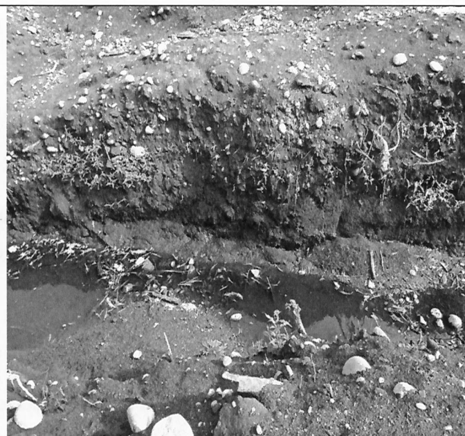
Fotografía N°8: Detalle de la foto anterior con afloramiento de líquidos lixiviados en canal de aguas lluvias en pared lado oeste del vertedero.
