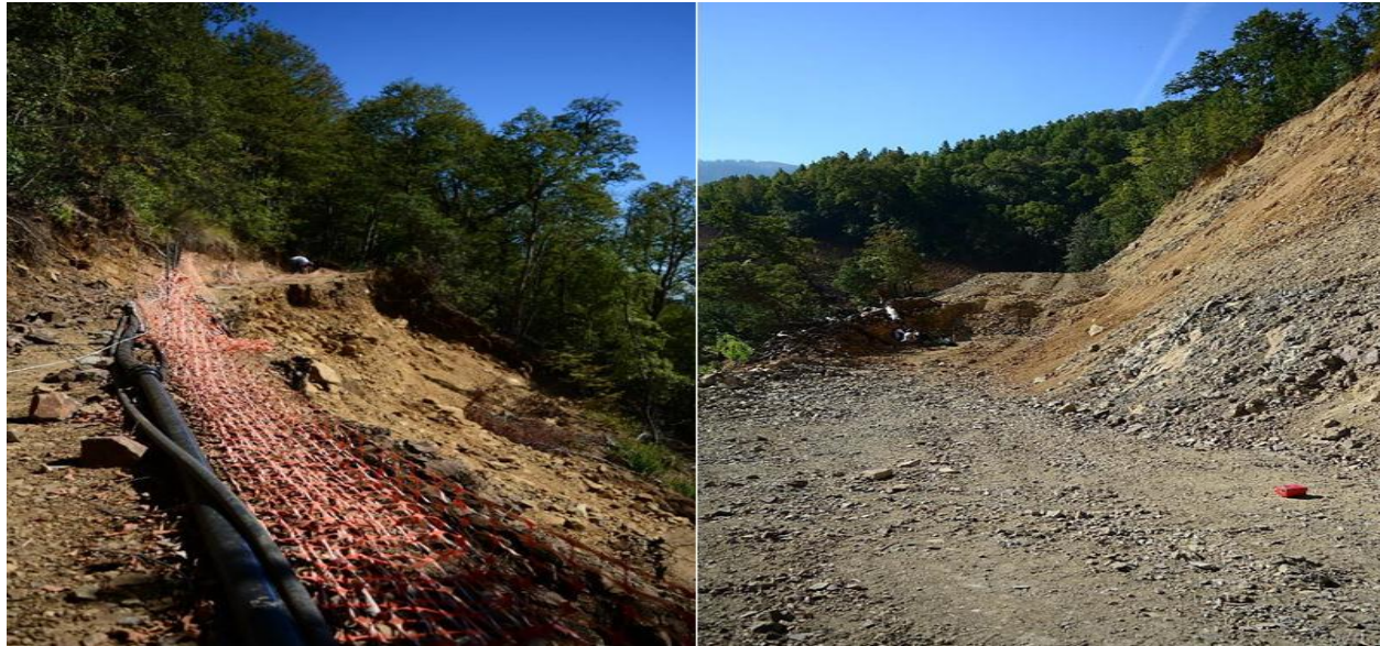
Fotografía 11. Sector deslizamientos camino vecinal (coordenada UTM WGS 84 Huso 19 sur: Este 295.410 - Norte 6.030.541).
