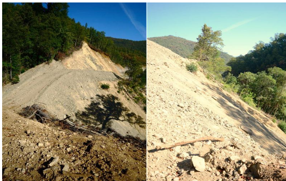
Fotografías 15 y 16. Sector con pendiente aproximada de 80%, dónde se presentan materiales de relleno de camino con poca densidad.
