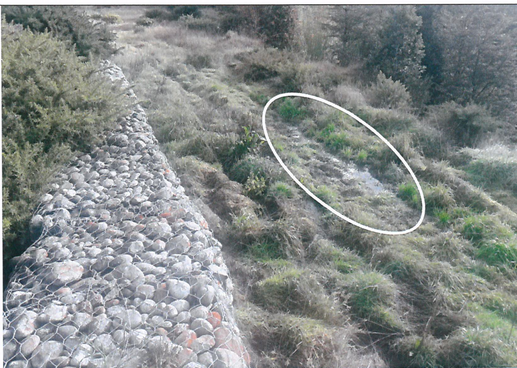
Fotografía 12: En círculo blanco, el sector del camino con apozamiento de líquidos, la distancia aproximada entre el sistema de contención y quebrada es de 5 metros.
