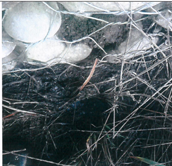
Fotografía 10: Líquido que escurre y traspasa el gavión de contención.
