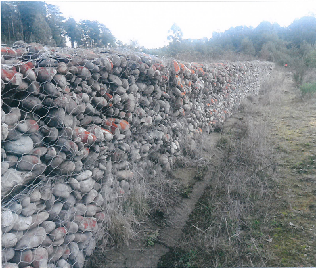
Fotografía 6: Sistema de contención zanjas por medio de gaviones.
