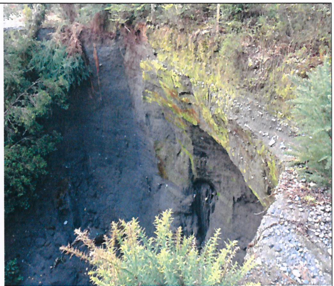
Fotografía 2: Desde otro ángulo, socavón de aproximadamente 5 metros de profundidad
