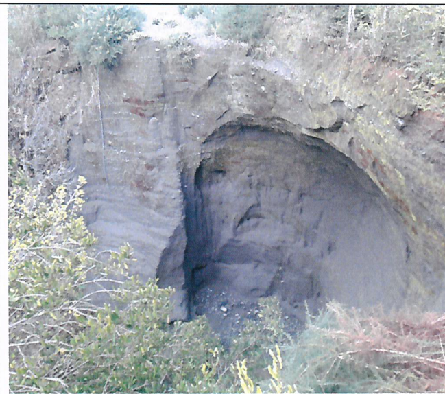
Fotografía 1: Socavón en el camino de acceso del vertedero.
