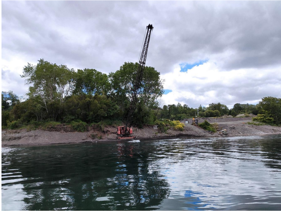
Figura 3-7: Río Rahue, maquinaria Dowling & Schilling extrayendo área desde el cauce por la orilla derecha
