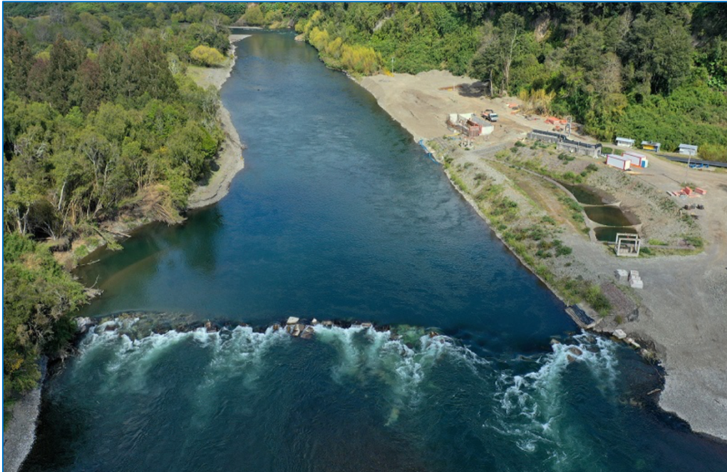
Figura 8: Pretil de Aquafarms, con bloques de concreto, ejecutado sin autorizaciones (Oct 2020)
