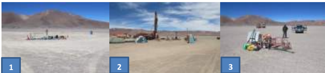
Figura 2.- Imágenes de ubicación de puntos de sondajes denunciados por CONAF. Imagen 1: Almacenamiento de materiales y equipamiento de sondaje N° 1; Imagen 2: Instalación de sondaje N°2; Imagen 3: Punto proyectado de sondaje N°3.
