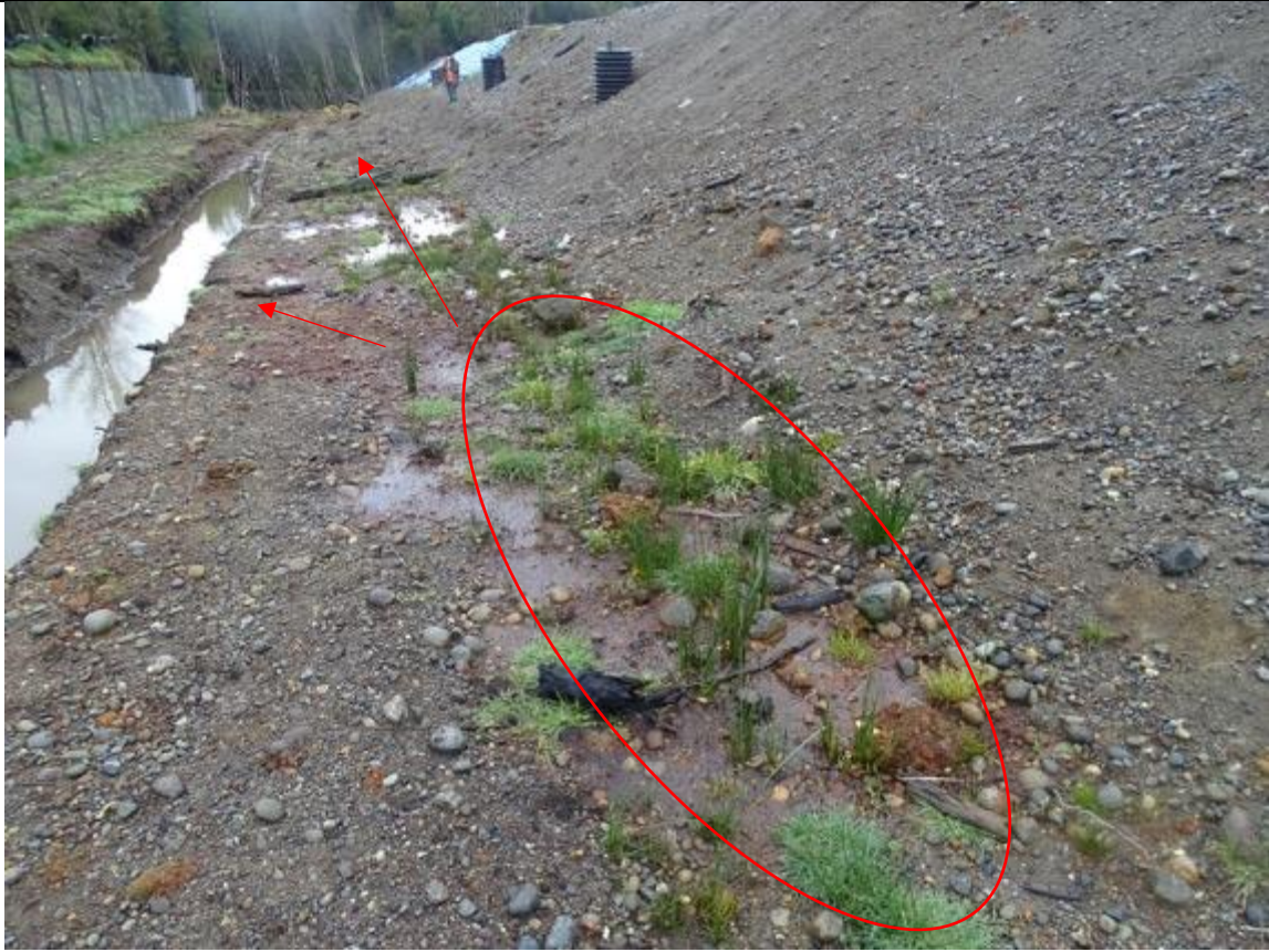
Fotografía N°3: Se observa lado Oeste de la masa de residuos con afloramiento de lixiviados.
