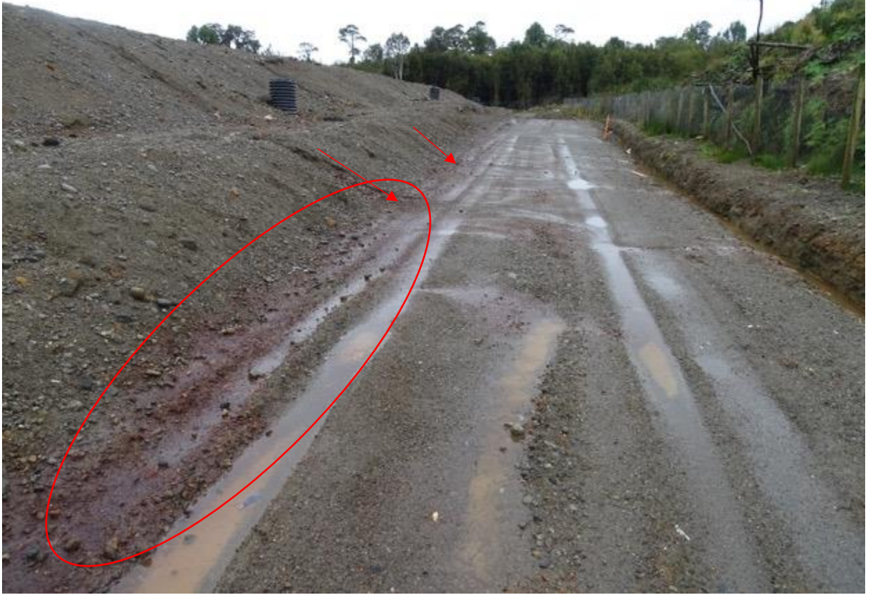
Fotografía N°9: Se observan manchones de lixiviados en la base de la masa de residuos en lado Este.
