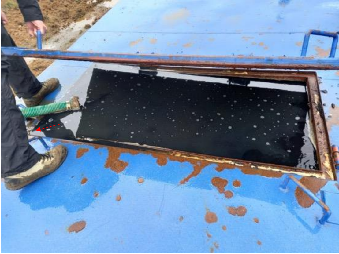
Fotografía N°14: Se observa tolva de acopio de lixiviados a máxima capacidad con escurrimiento lateral (flecha roja).
