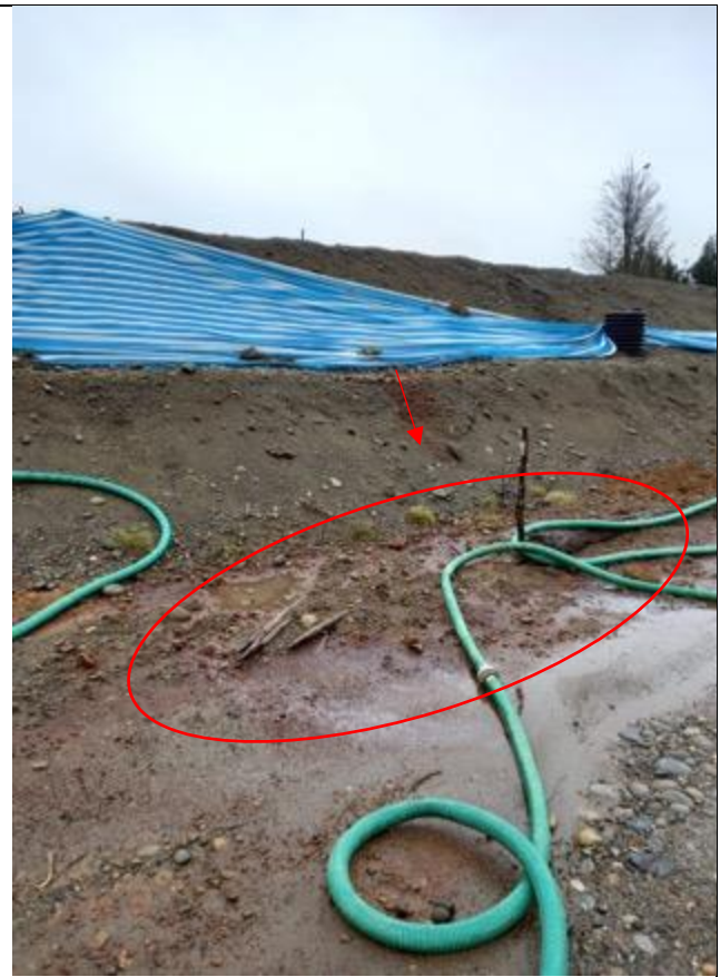
Fotografía N°5: Se observa escurrimiento de lixiviados por talud hasta la base de la masa de residuos en lado Norte.
