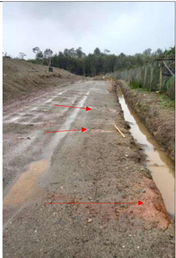
Fotografía N°11: Se observa escurrimiento de lixiviados hacia canal de aguas lluvias Este.
