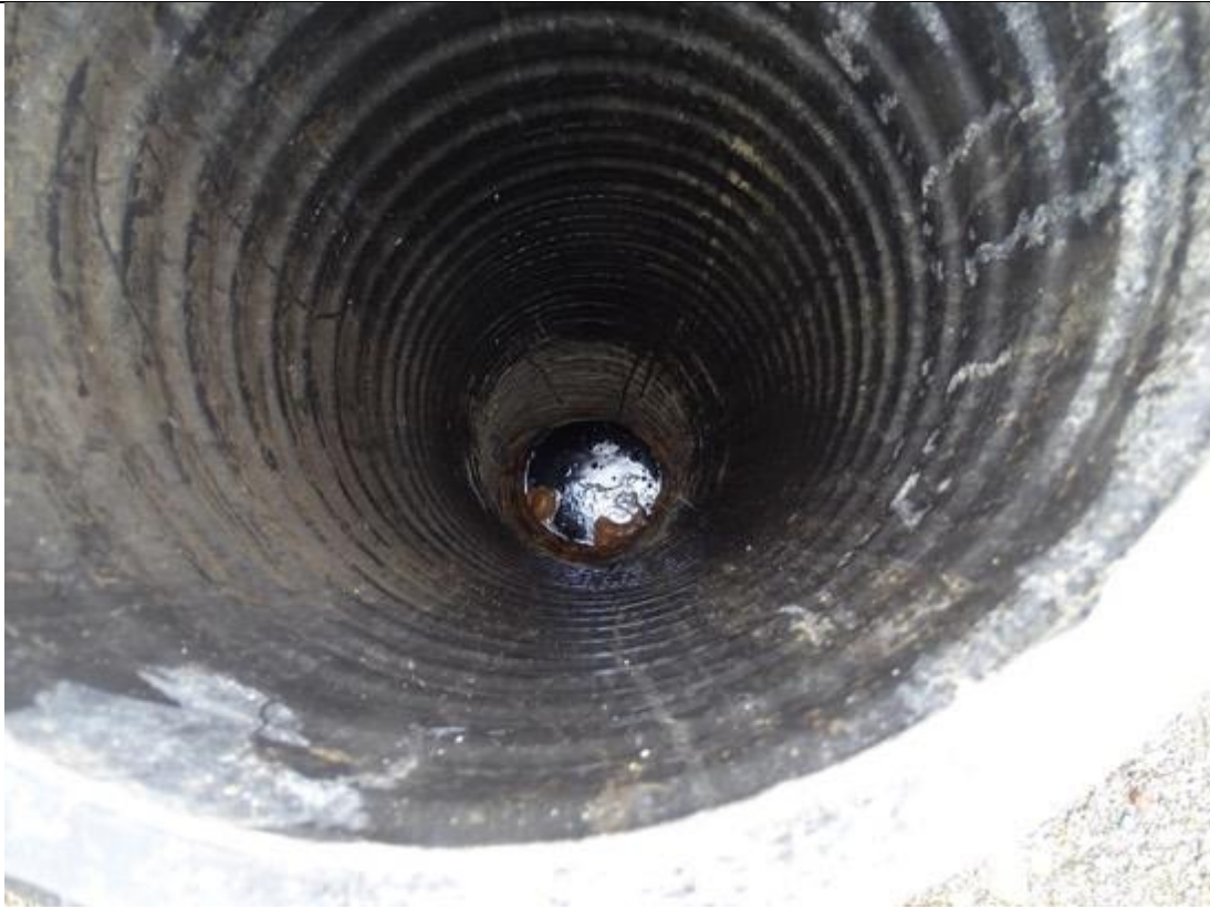
Fotografía N°8: Se constata existencia lixiviados en chimeneas de ventilación. Se observan burbujas.
