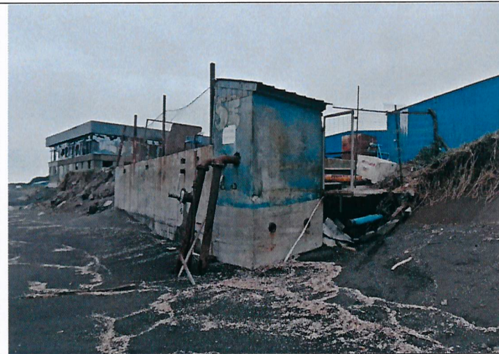
Fotografía N°1: Instalaciones Emisario Submarino en la playa del parque industrial.
