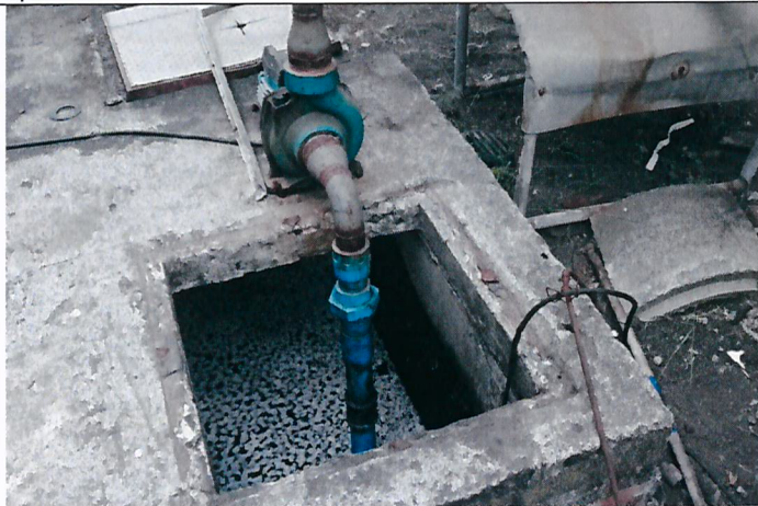
Fotografía N°7: Estanque de Almacenamiento de los Riles del área de congelado.
