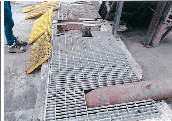
Fotografía N°5: Pozo de decantación N°1 de los Riles del área de operación.
