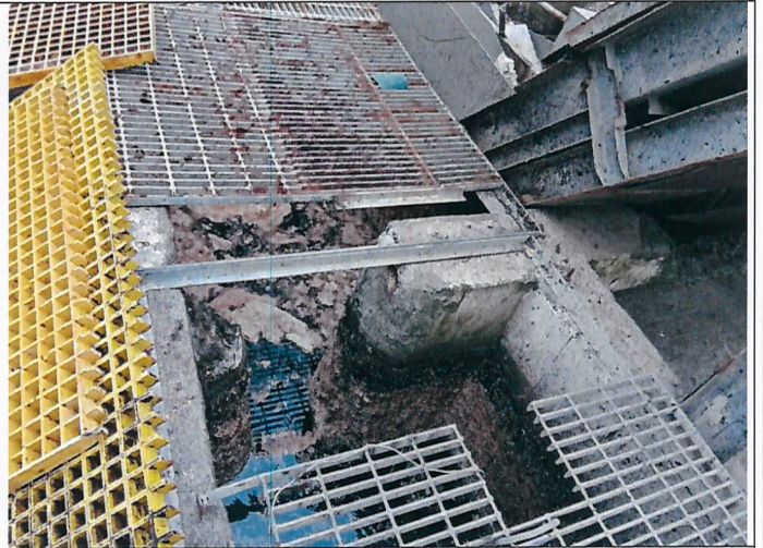
Fotografía N°6: Pozo de decantación N°1.
