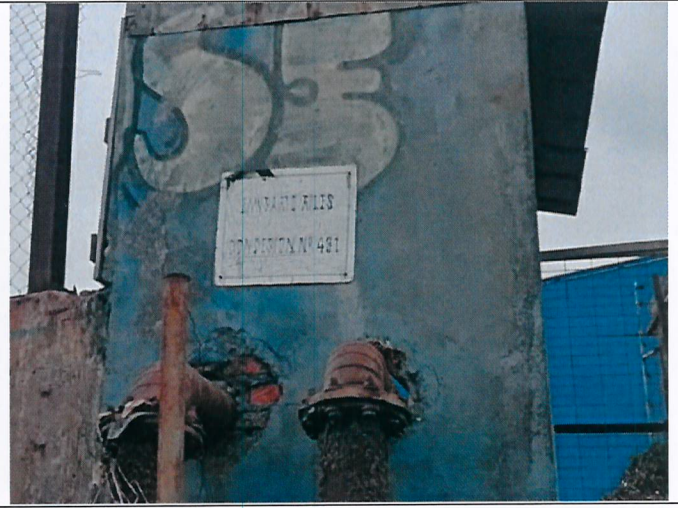
Fotografía N°2: Instalaciones emisario submarino en la playa del parque industrial.
