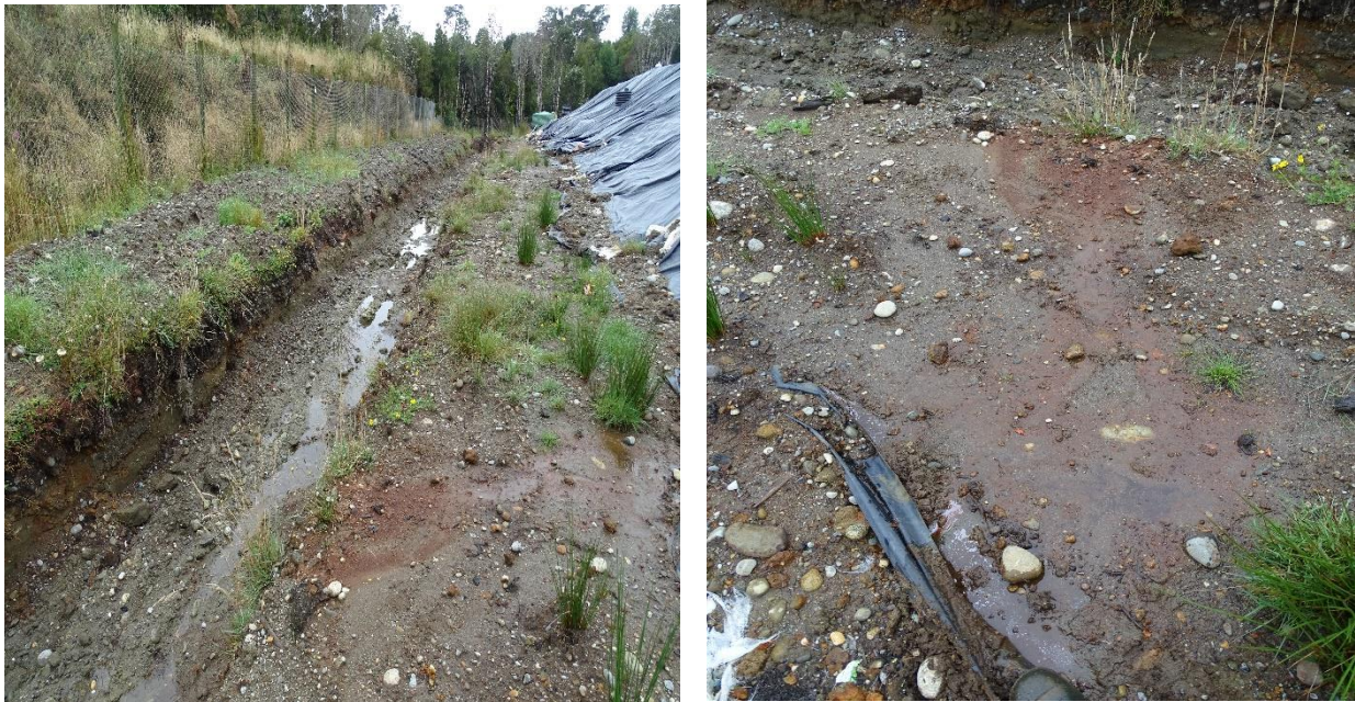
Fuente: fotografías tomadas en inspección de fecha 3/3/2022
