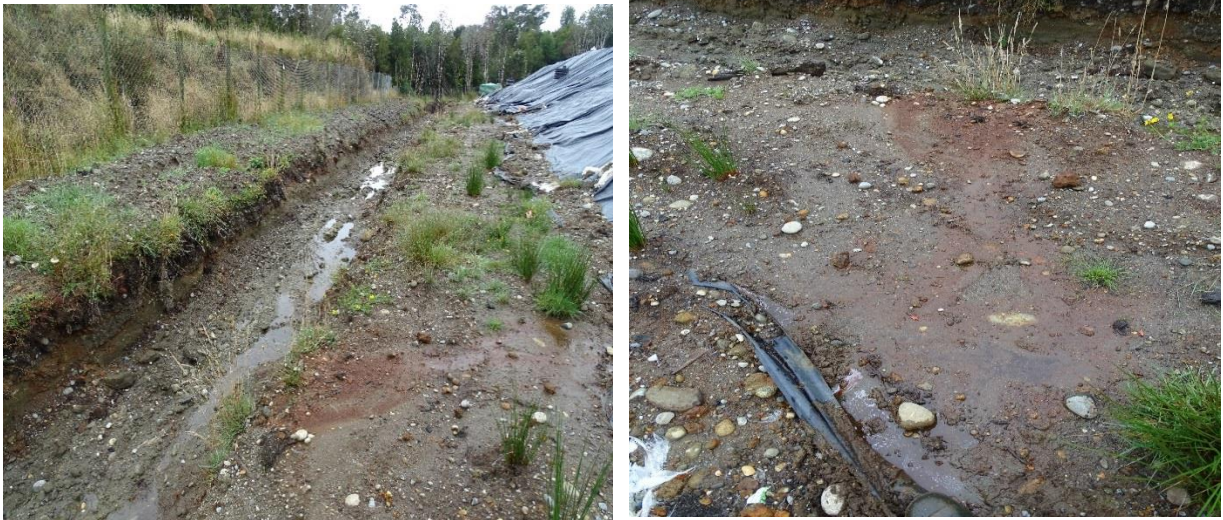
Fotografías 1 y 2: canalización de aguas lluvias y afloramiento de lixiviados
