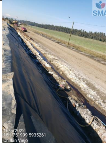
Foto 14 fuga lixiviados zona sur CITA 16.05.2022
