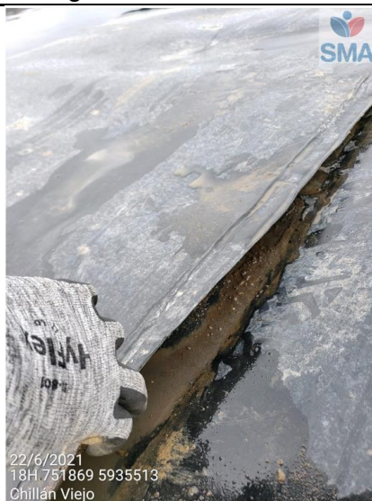
Foto 1 de Acta Daño termo sellado Celda IV.1.B Poniente.
