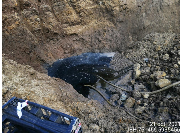
Foto 11: Incidente fuga lixiviados 21.10.2021
