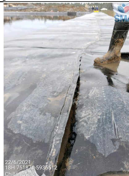
Foto 2 de Acta Daño termo sellado Celda IV.1.B Poniente.
