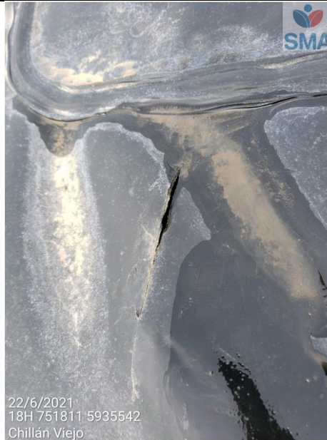
Foto 9 de Acta Daño Celda V.1.
