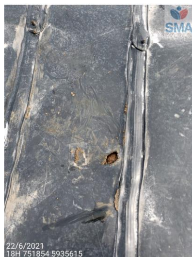
Foto 3 de Acta Daño Celda V.1.
