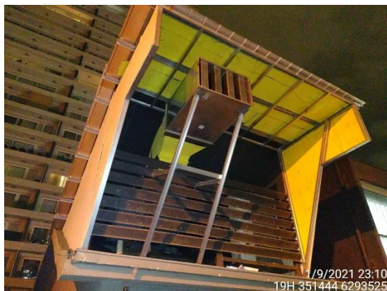
Extractor de aire
