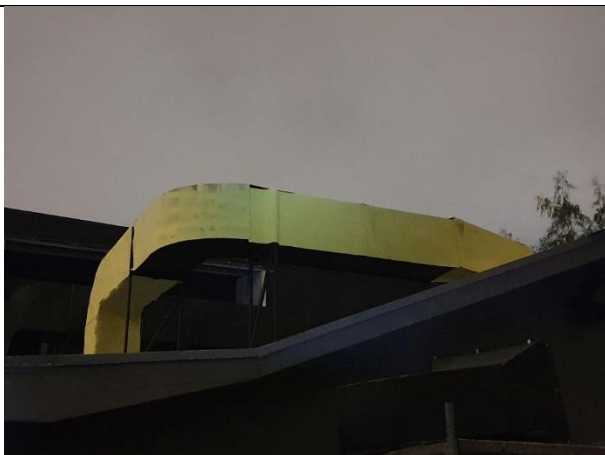
Ductos forrados con lana mineral
