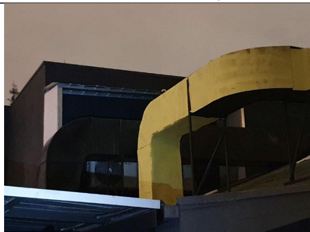
Semiencierro unidades de aire acondicionado
