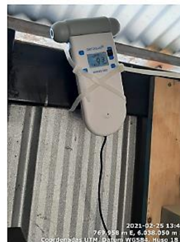
Imagen 2: Sensor de NH 3 instalado en la caseta de riego
