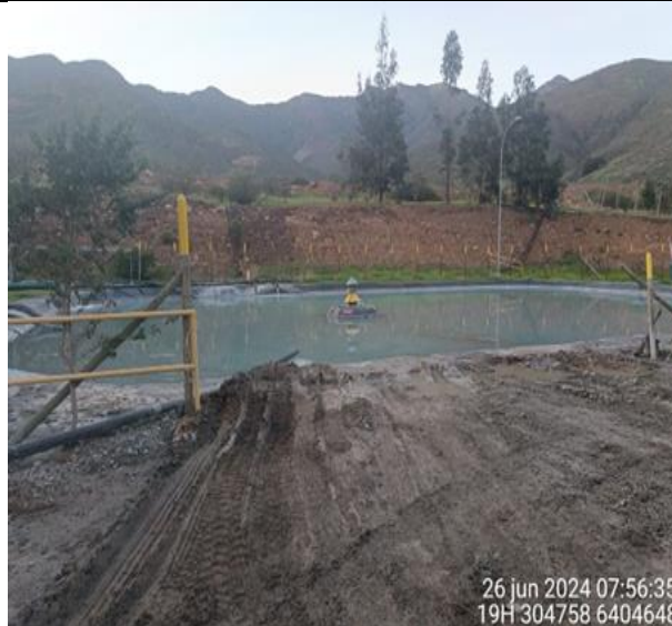
IMAGEN N°9. CONDUCCIÓN DE AGUAS HACIA PISCINAS DE AGUAS CLARAS O AGUA RECUPERADA
