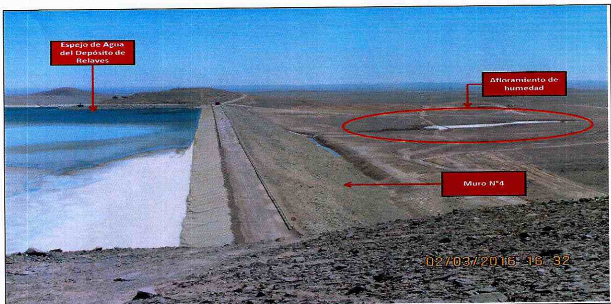
Figura 6. Fotografía de fecha 02 de marzo de 2016, aguas abajo del muro N°4 del Depósito de Relaves, en la que se observa afloramiento de humedad (costras salinas) y espejo de agua del depósito de relaves de relaves.
