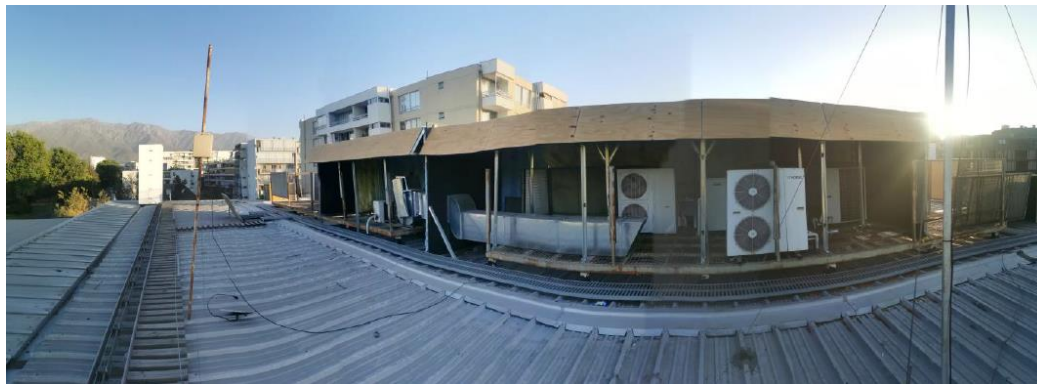
Figura 3. Vista panorámica semiencierro acústico a equipos de aire acondicionado y extractor de aire.
