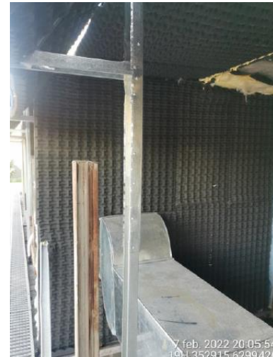
Figura 2. Material fonoabsorbente en la cara interior del encierro
