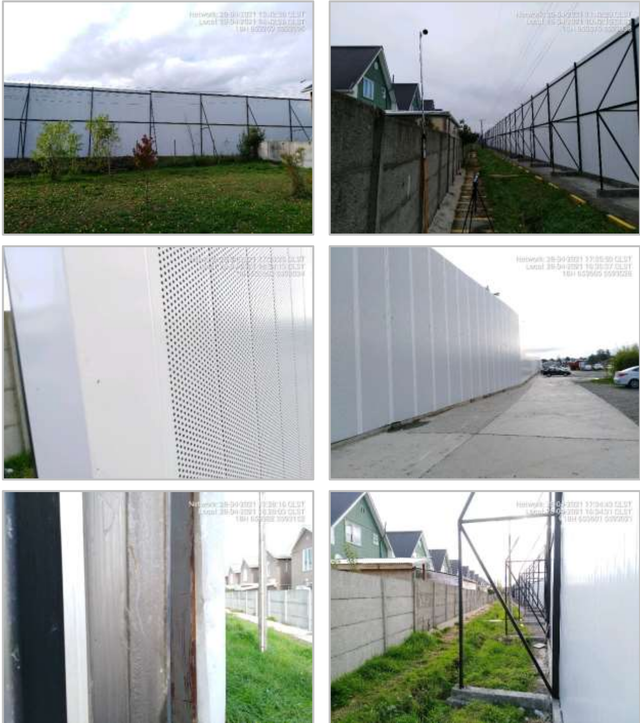
Figura 2: Barrera Acústica o Muro de insonorización.
