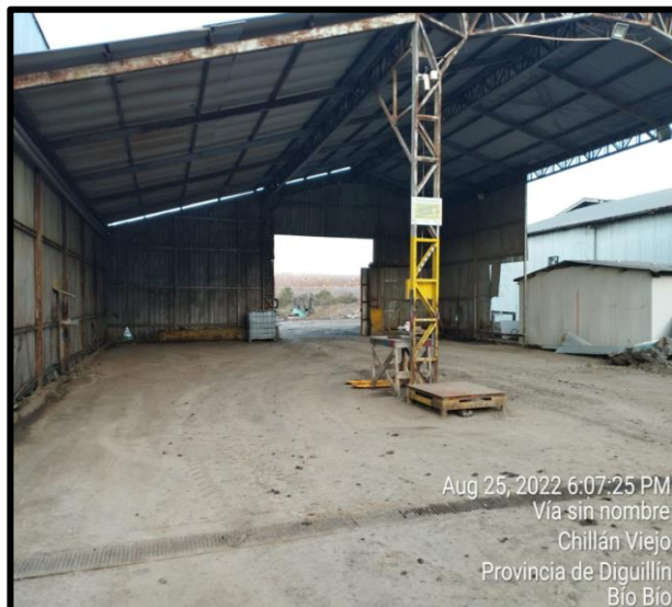
Figura 1. Sector validación sin residuos
