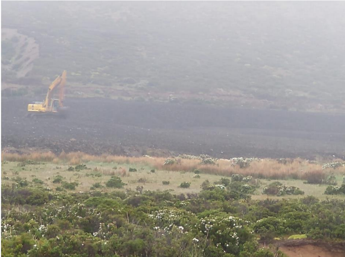
Fig. 8. Imagen de la retroexcavadora trabajando en la reconstitución del área explotada. Rellenando área explotada con suelos y material vegetal de la zona, acopiados al costado de dicho área.
