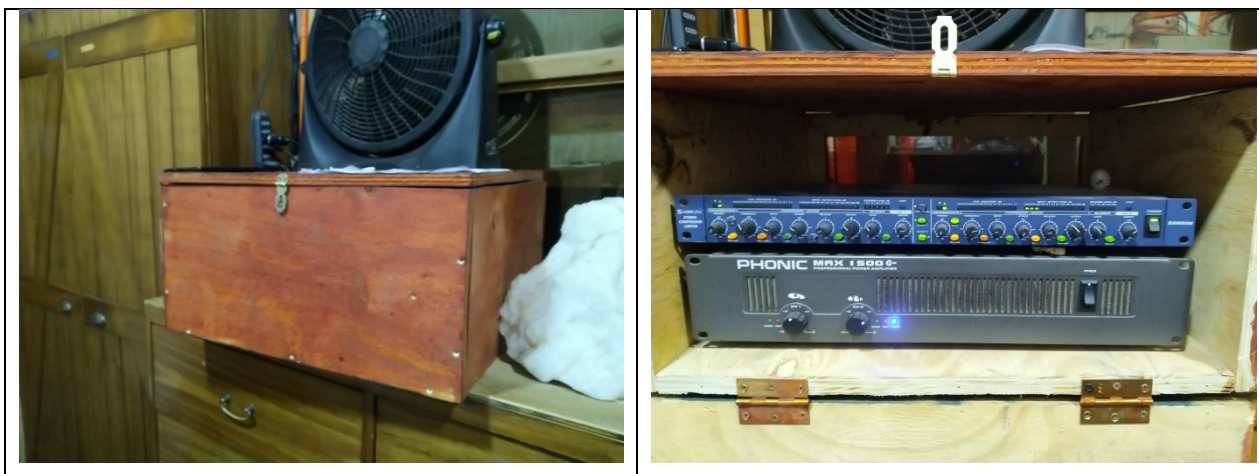
Ilustración 1. Ubicación del limitador en la oficina de administración.
