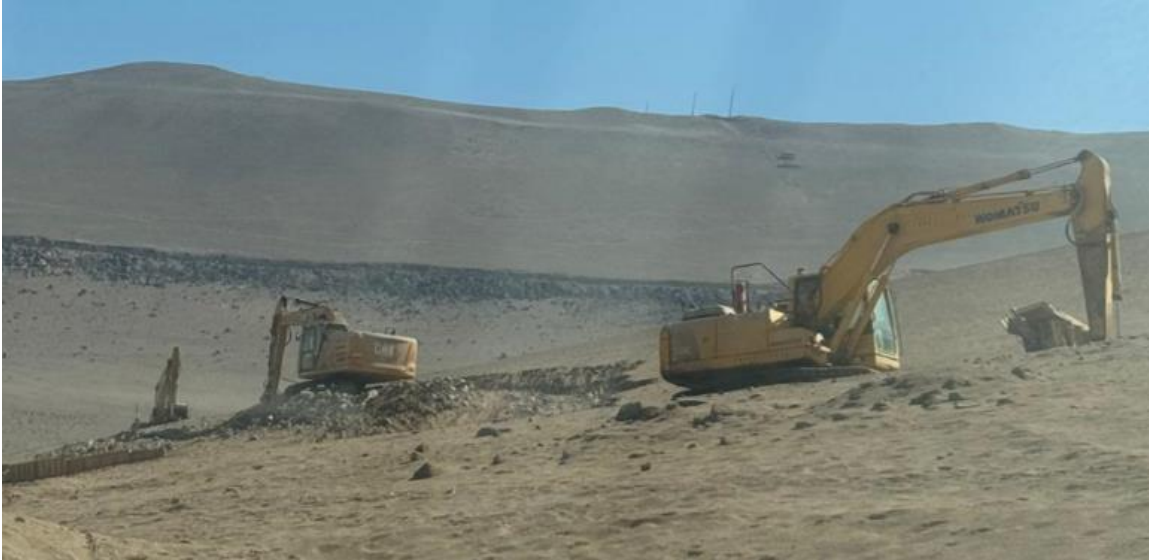
Figura 8: Visión panorámica de las maquinarias 02,03 y 04
