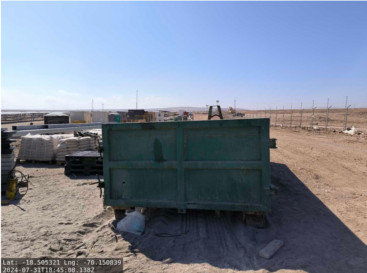
Figura 4: Batea de residuos 01 apostada al interior del Proyecto, Posterior
