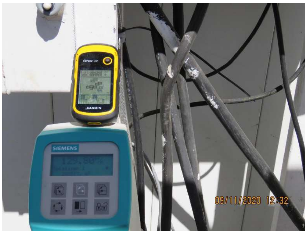
Fig. 6. Coordenadas Tablero eléctrico y flujómetro Siemens
