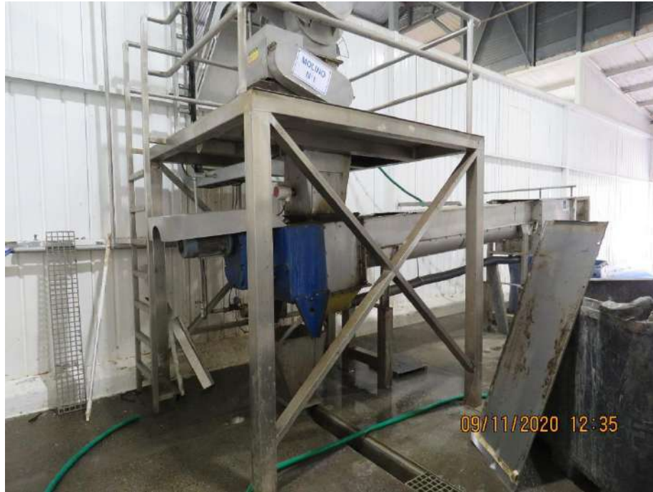
Fig. 7. Zona de desbaste de sólidos gruesos (Trommel)
