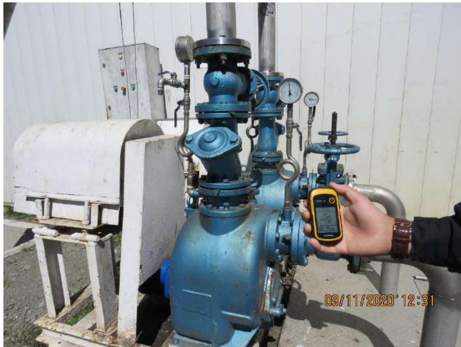
Fig. 3 Bombas de impulsión a zona de Trommel
