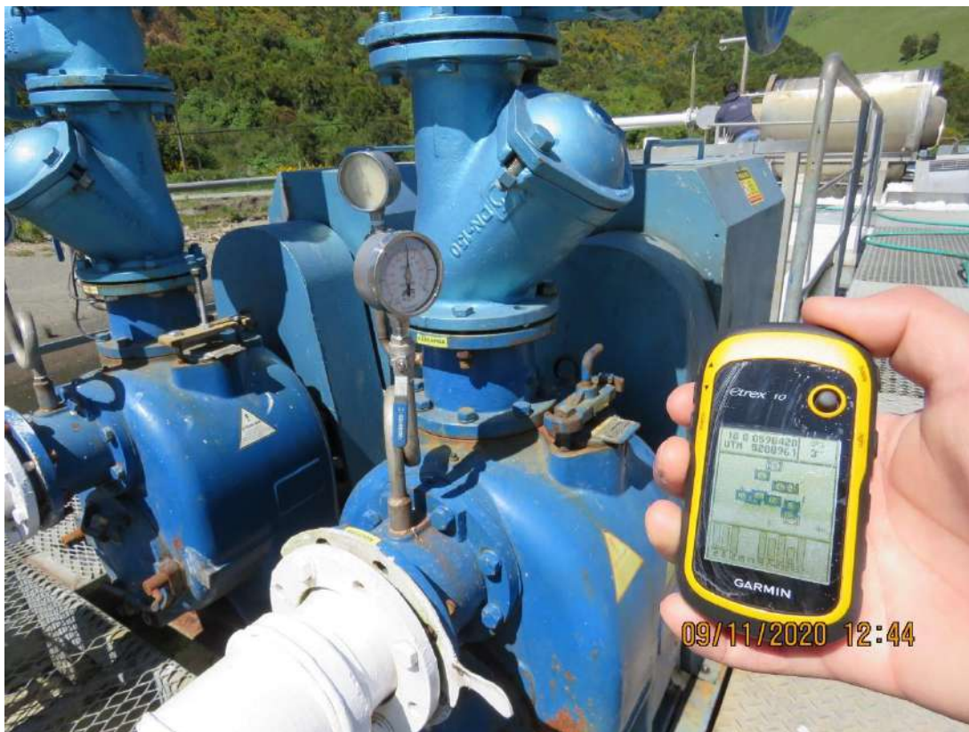
Fig. 14. Bombas de impulsión a emisario submarino
