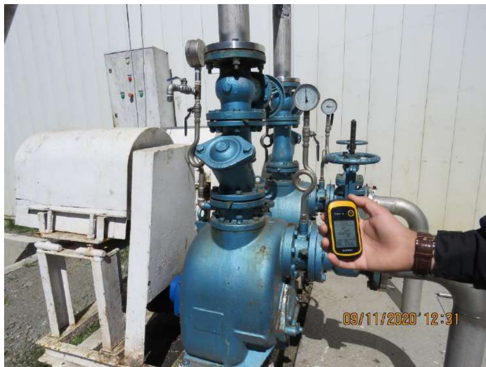
Fig. 3 Bombas de impulsión a zona de Trommel
