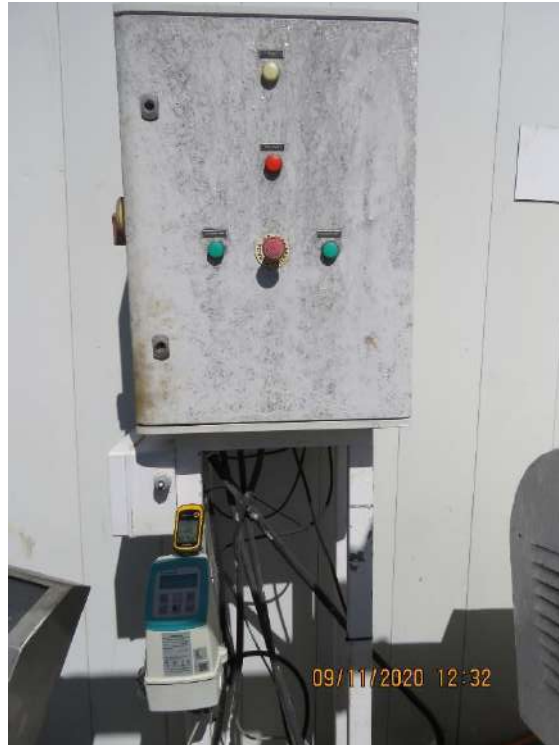
Fig. 5. Tablero eléctrico y flujómetro Siemens
