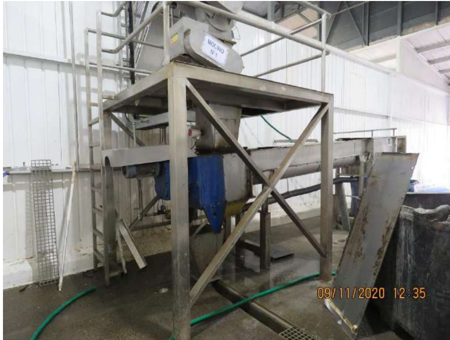
Fig. 7. Zona de desbaste de sólidos gruesos (Trommel)
