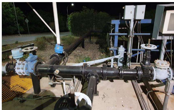
Válvulas y cañerías de descarga de Bombas
