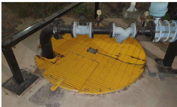
Medidor de descarga y cámara de descarga RILES
