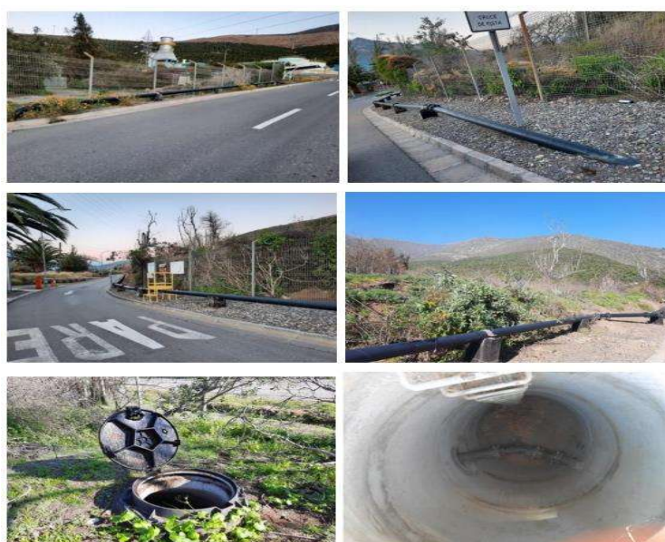
Cañerías (Tramo hacia Puente Pachacama, Bajo puente y Descarga a Rio Aconcagua
