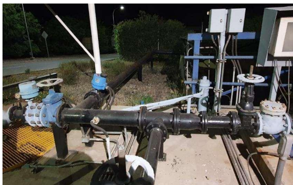
Válvulas y cañerías de descarga de Bombas
