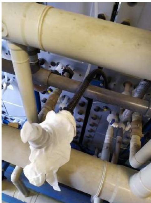
Ilustración 4 Desconexión eléctrica de los Stack
