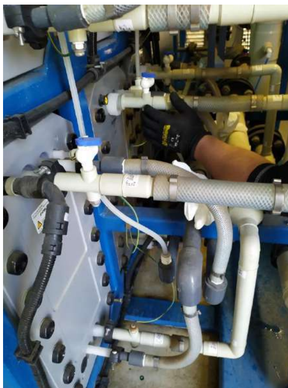
Ilustración 5 Desconexión hidráulica de los Stack
