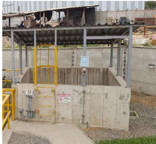
Fotografía 7-1: Cámara de bombas y llave de muestras
