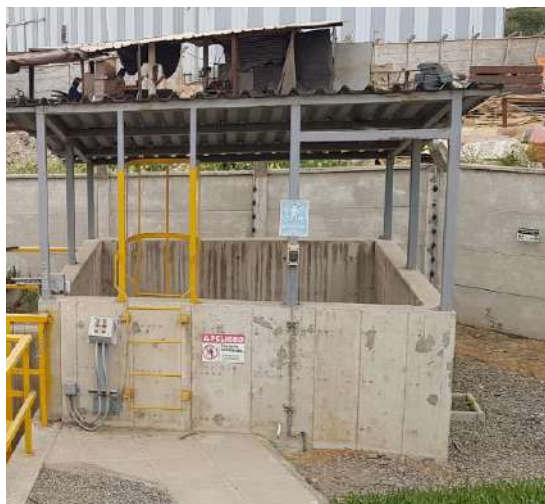
Fotografía 7-1: Cámara de bombas y llave de muestras
