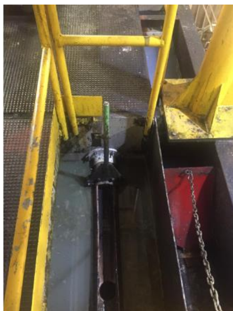
Imagen N° 5. Estanque 14, separación de aceite
