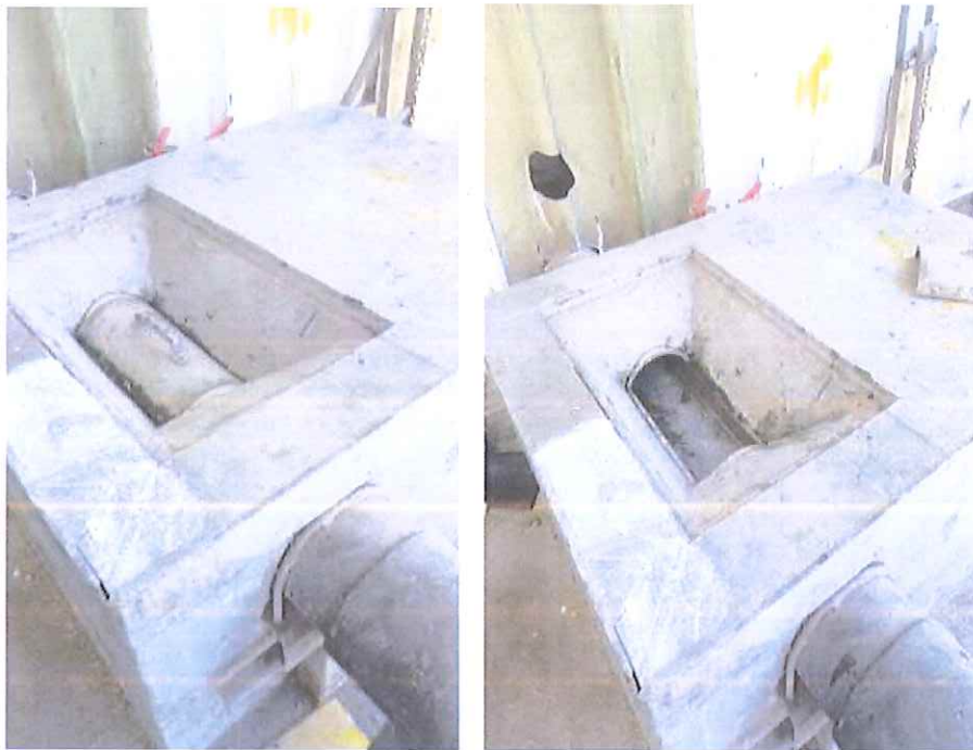
Imagen 3: Camara de muestro “PUNTO 1 CANAL DE DERRAME”
