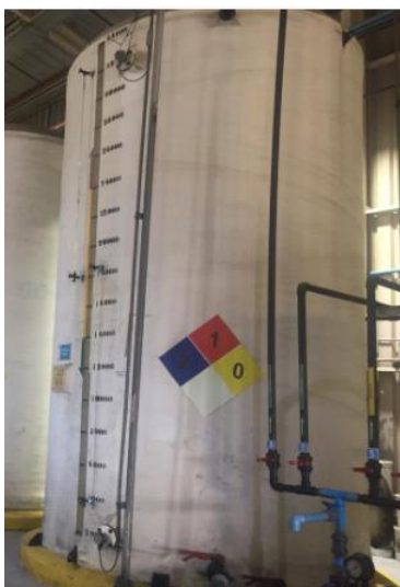
Imagen N°16. Estanque de acumulación N°3
