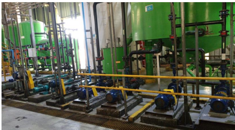
Imagen N°19. Bombas de piso
