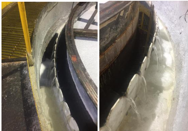
Imagen N°13. Agua clarificada proveniente del flotador
