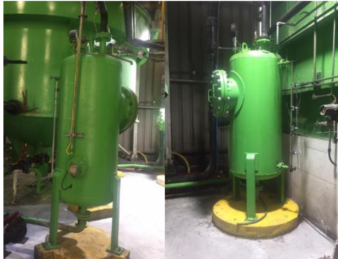
Imagen N°10a Presurizador Principal, Imagen N°10b Presurizador Back ups
