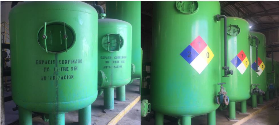
Imagen N°14a Filtro de arena, Imagen N°14b Filtro de carbón activado
