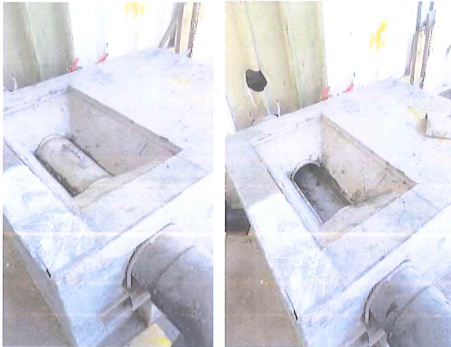
Imagen 3: Camara de muestro "PUNTO 1 CANAL DE DERRAME"
