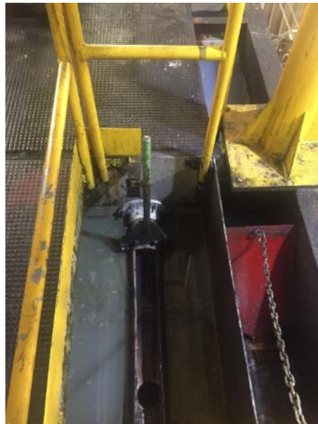
Imagen N° 5. Estanque 14, separación de aceite
