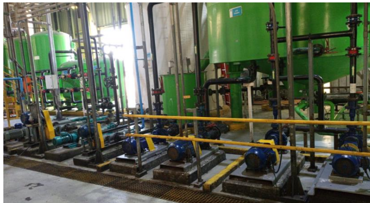
Imagen N°19. Bombas de piso
