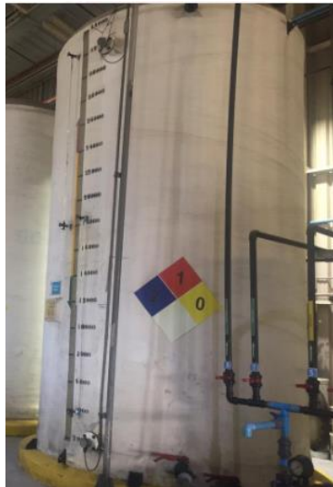
Imagen N°16. Estanque de acumulación N°3
