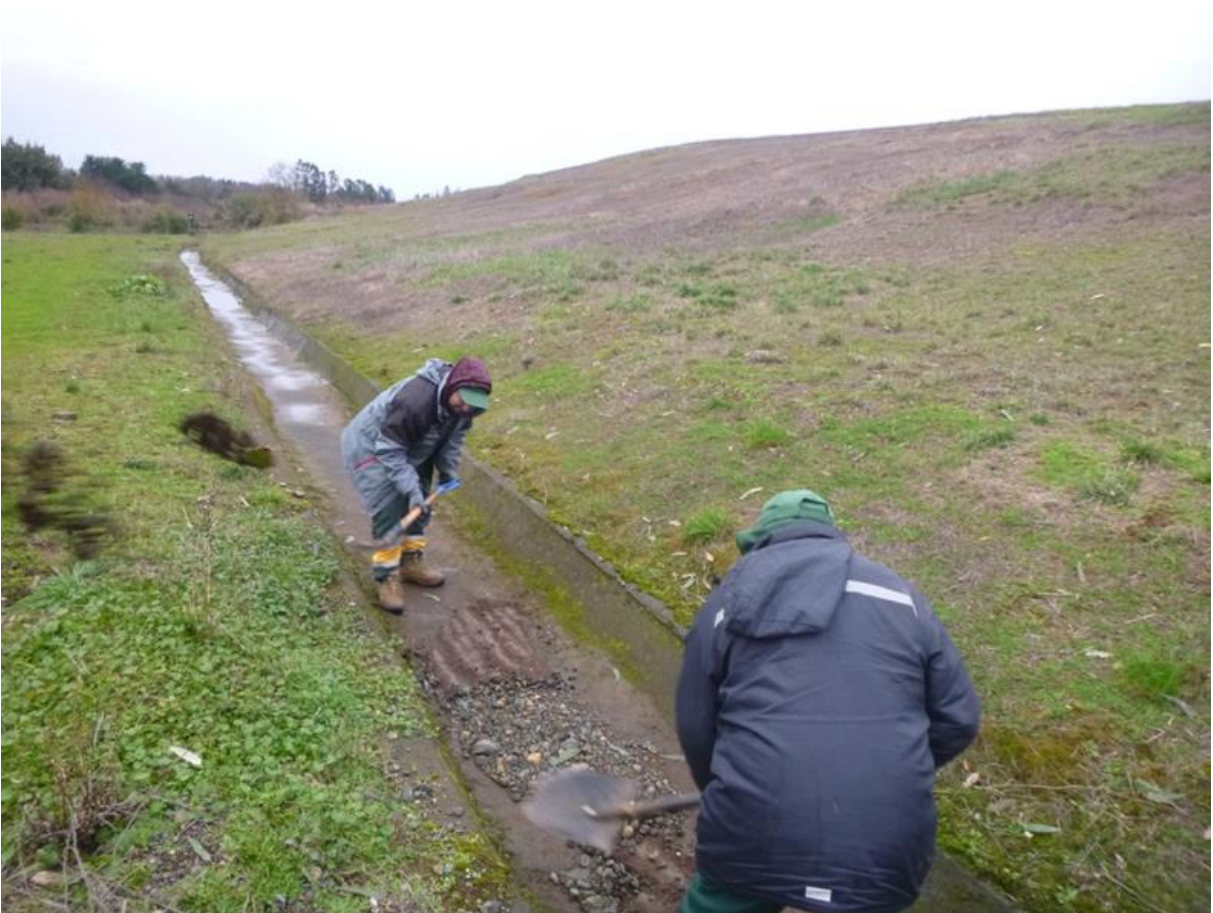
Imagen N° 4.- Limpieza canal de intercepción de aguas lluvias perimetral, lado B y C estero sin nombre.
