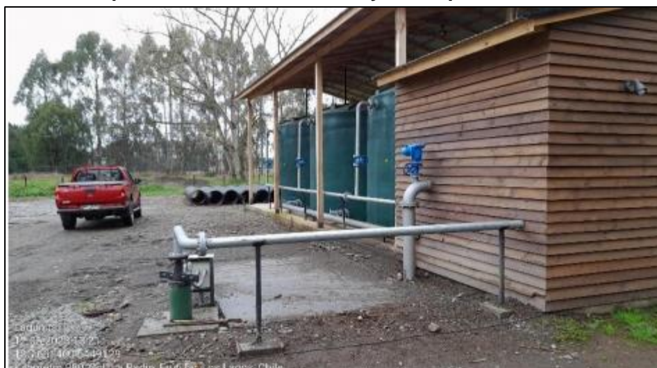
Fuente: Fotografía N° 7 del Informe de Fiscalización Ambiental DFZ-2023-1583-X-SRCA
