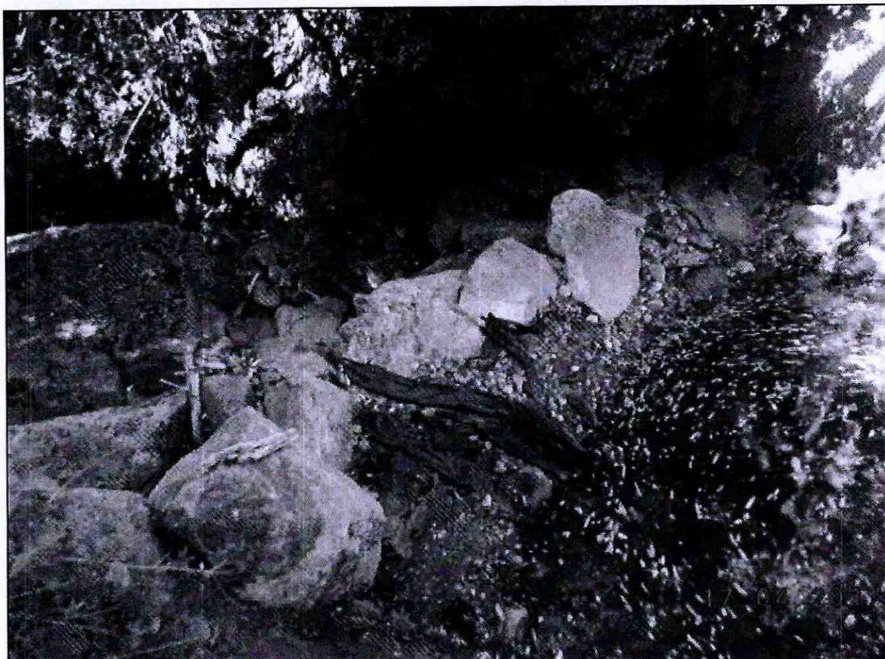
Fotografía N° 8: Se observa muro de captación de aguas construido con material terrígeno y pedregoso que actúa como bocatoma, emplazado en las coordenadas 5.413.078 Norte y 722.763 Este
