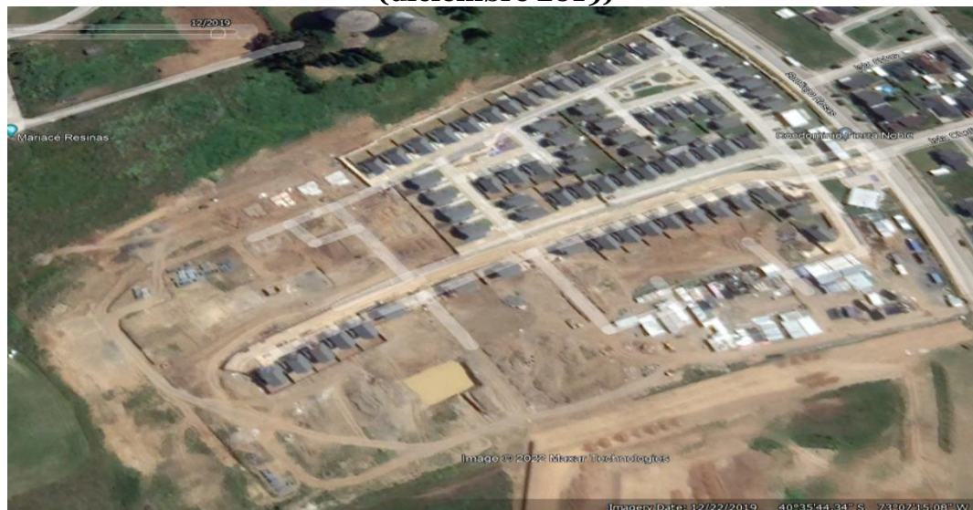
Imagen 6: Continuación de las obras de TN I y II e instalaciones de faenas (diciembre 2019)
