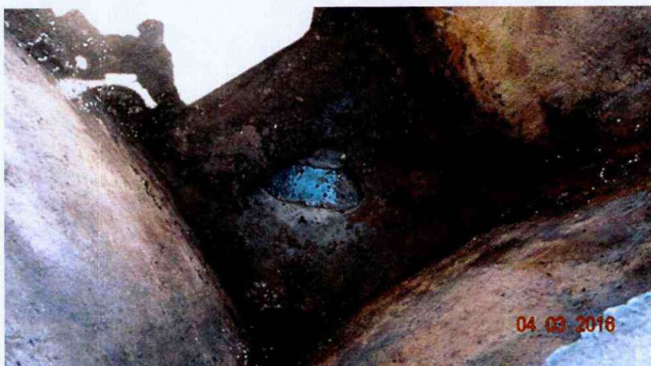
Imagen 5. Evidencia de presencia de líquidos al interior de uno de los pozos de infiltración.
