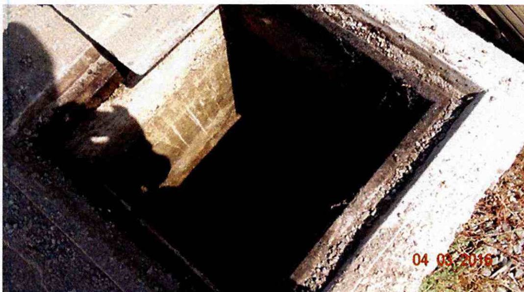
Imagen 4. Evidencia de pozo de infiltración no sellado.
