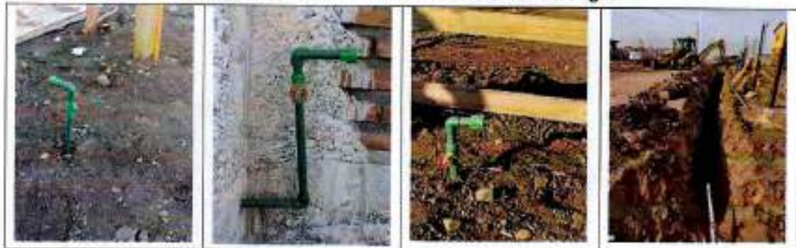
Imagen N° 12. Instalación de abastecimiento de agua
