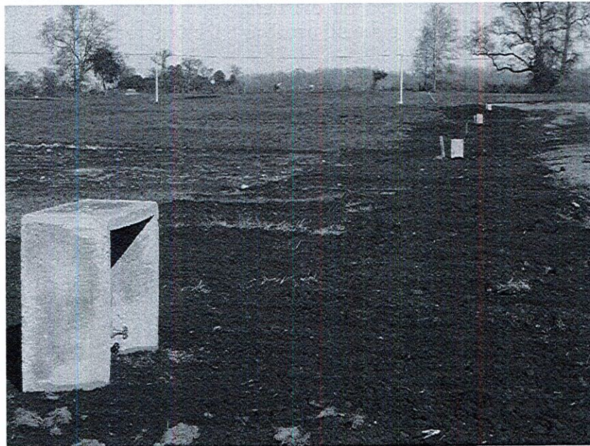
Imagen N° 10. Serie de arranques de la red de agua
