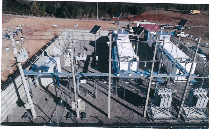
Figura 13. Central eléctrica de respaldo. Coordenadas 18 H 5587319.12 m N; 639184.84 m E (Coordenadas (UTM) Datum: WGS84). Junio 2020
