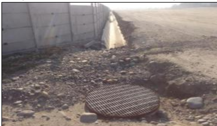
Imagen N° 1: Sistema de recolección de aguas lluvia
