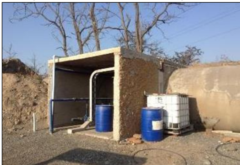
Imagen N° 6: Planta de tratamiento de agua potable
