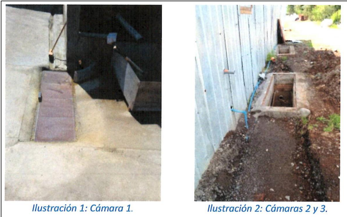
Imagen N°18: Registros de las cámaras de retención de residuos sólidos del efluente.
