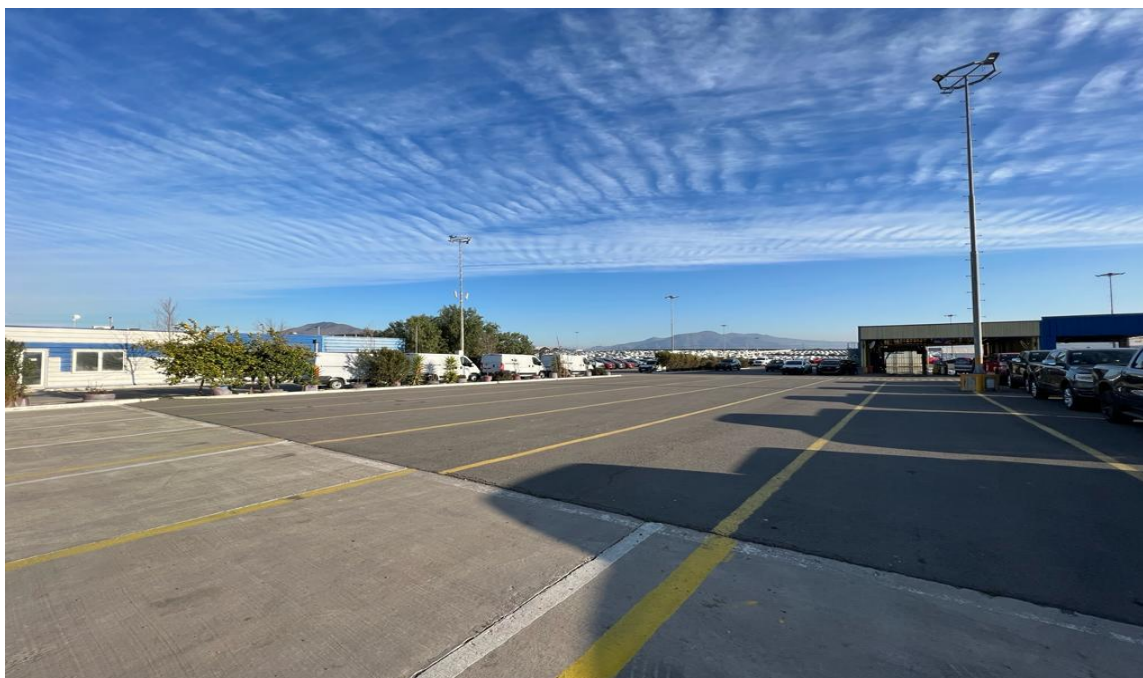
Imagen N°3: Zona de losa en contraposición a lechada asfáltica
